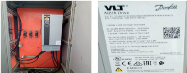
Fig. 1 - Inversor de Frequência Danfoss VLT (Aqua Drive FC-202/150-HP) instalado na unidade consumidora*
