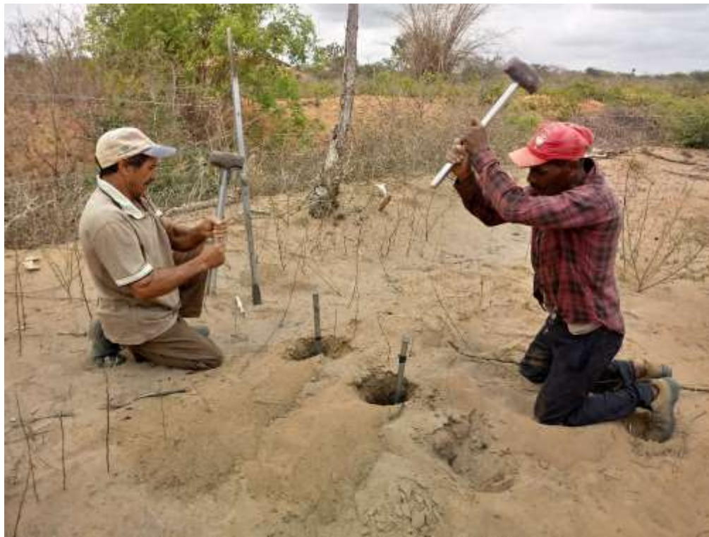
ELETRODOS DE INJEÇÃO DE CORRENTE ELÉTRICA
