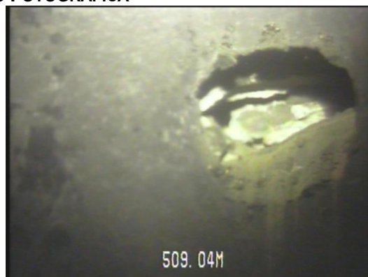
FOTOGRAMA 03 - Visada lateral do revestimento com rompimentos aos 509,04 metros.
