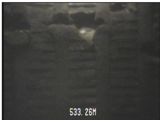
FOTOGRAMA 08 - Visada lateral de filtro colmatado e com rompimento aos 533,26 metros.
