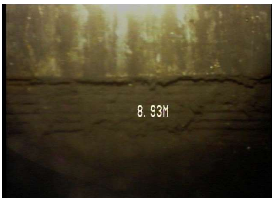
FOTOGRAMA 02 – Visada lateral aos 8,93 m mostrando emenda entre tubos.
