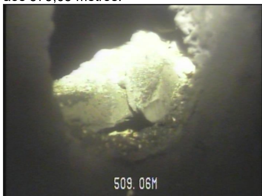
FOTOGRAMA 04 - Visada lateral do revestimento com rompimentos aos 509,06 metros.
