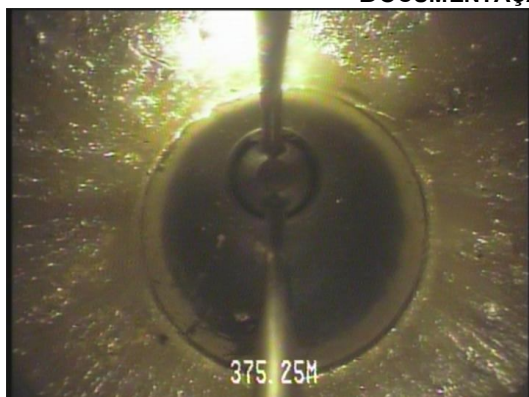
FOTOGRAMA 02 - Visada de fundo aos 375,25 metros*, que mostra o nível d'água aos 375,65 metros.
