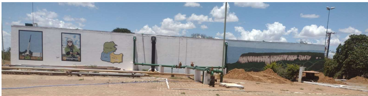
Figura 7: Reservatório Semienterrado Existente ( V=5.000 \text{ m}^3 ) na Serra dos Carneiros
