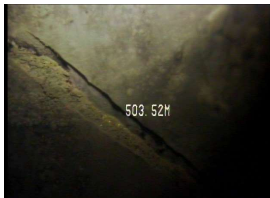
FOTOGRAMA 09 - Visada lateral aos 503,52 m mostrando fissura no tubo liso.
