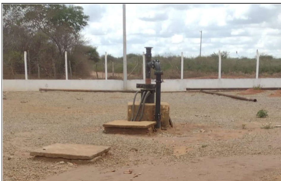
Figura 6: Poço Tubular Profundo PP5
