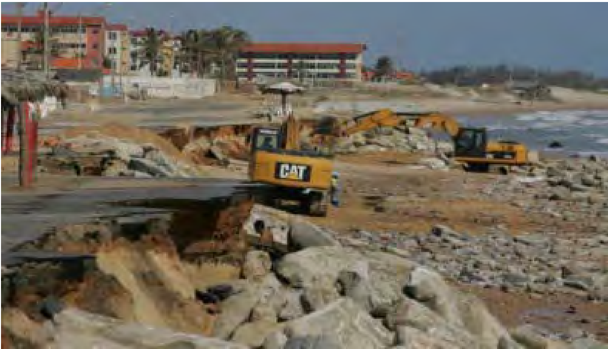
Figura 7.7 - Recente destruição da orla da praia do Icarai, no município de Caucaia, pela erosão marinha. Apenas o trecho protegido pelo bagwall (dissipador de marés) implantado, em meados de 2012, resistiu a ação das ondas.
