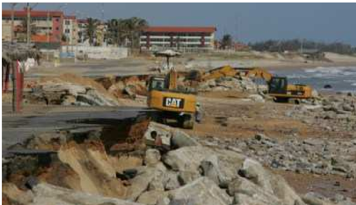
Figura 119 - Destruição da orla da praia do Icaraí, no município de Caucaia, pela erosão marinha. Apenas o trecho protegido pelo bagwall (dissipador de marés) implantado, em meados de 2012 e recentemente alvo de reforço na sua estrutura, resistiu a ação das ondas.
