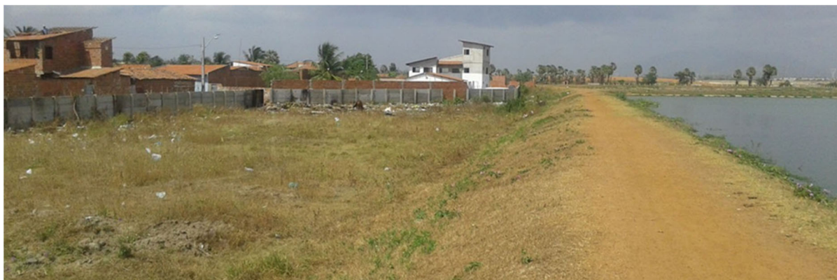
Figura 8: ETE Conjunto Palmeiras – Deterioração dos Taludes
