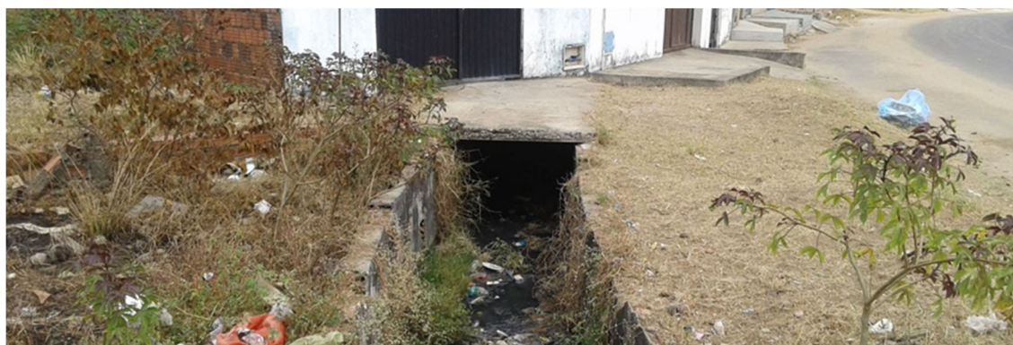
Figura 10: Sistema de Drenagem de Águas Pluviais
