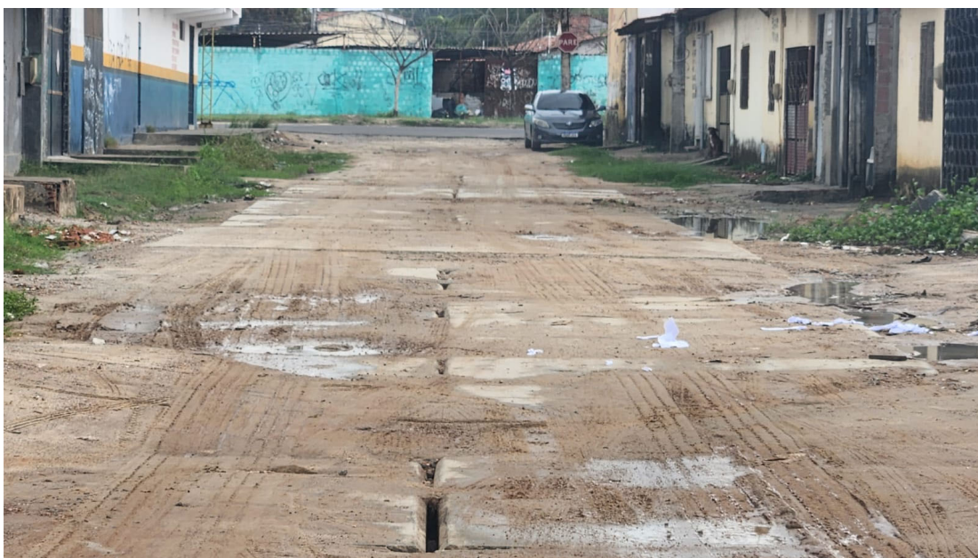
Fotografia de Rua com Galeria de Drenagem.
